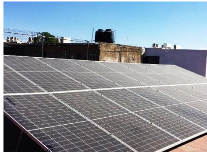
Sistema Fotovoltaico de la Escuela Preparatoria Regional de Tonalá
