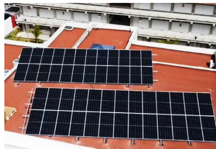
Sistema Fotovoltaico de la Escuela Preparatoria N°18
