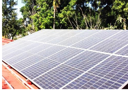
Sistema Fotovoltaico de la Escuela Preparatoria N°12
